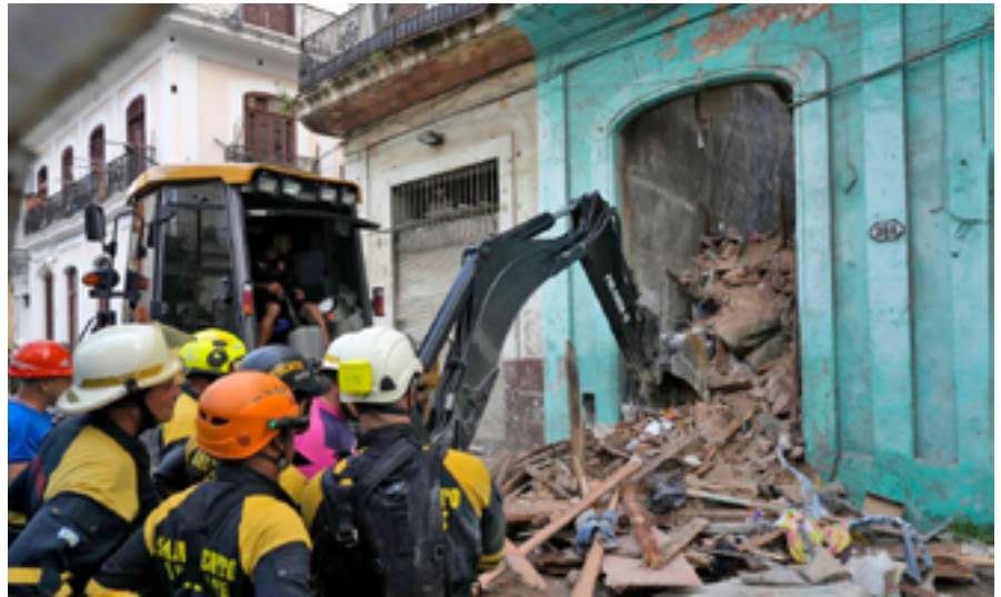
Bomberos retiran los escombros de un edificio que se derrumbó el 4 de octubre en La Habana / AP
